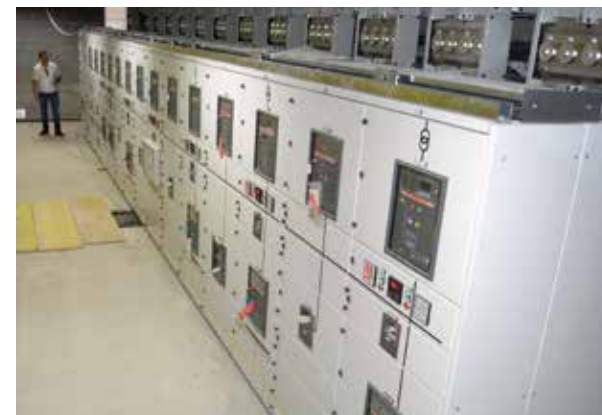
Il power center di Cabel System da 14 metri che gestisce 7 trafo da 2.000 kVA dentro una cabina elettrica
